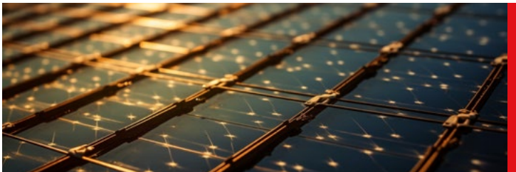
Impianti con pannelli solari
